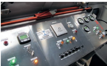
Pupitre de contrôle de locotracteur MTE T1951 rénové avec mise en place des agrès Reconditioned driven control desk of a locomotive MTE T1951 with apparatuses installed
