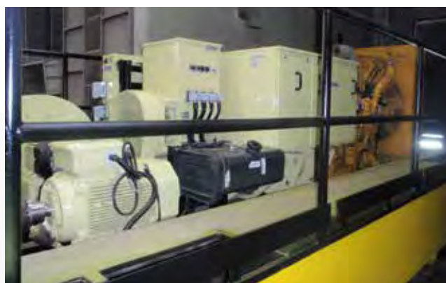
Compartment moteur diesel avec alternateur de locotracteur BB Favet Girel 72 t Diesel engine with alternator of a locomotive BB Favet Girel 72 tons
