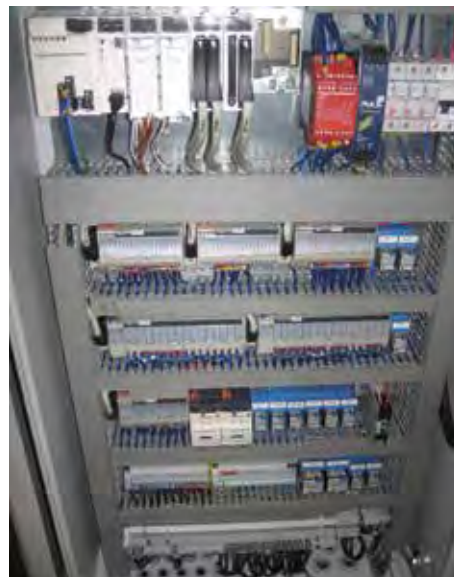
Armoire électrique neuve avec automatisme New automatic electrical cabinet
